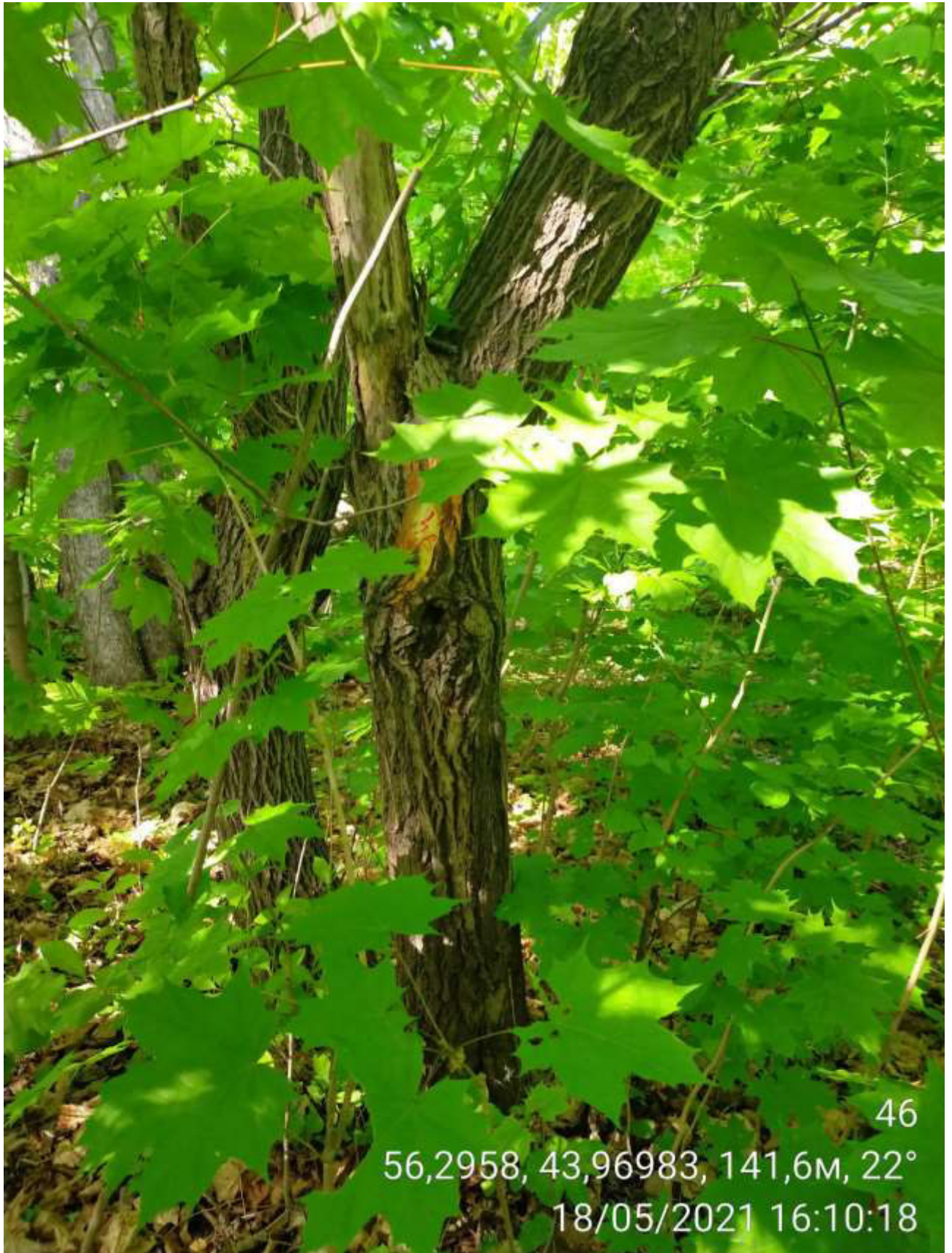
Дерево № 46 (Стволовая гниль)
